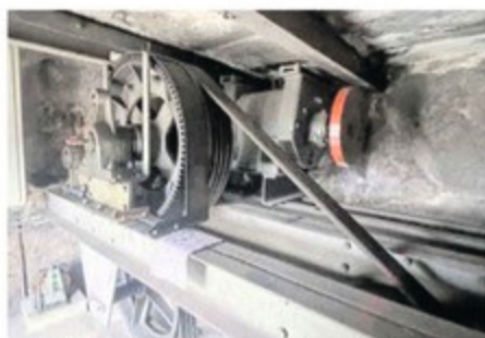
Blick in den Technikraum des Lastenaufzugs, der sich im Inneren des Turms befindet und noch immer funktioniert.
